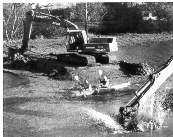
Es ist geschafft: Gleich zwei Bagger geben dem Wasser im neuen Flussbett freien Lauf
